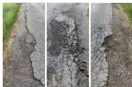
Schäden an der Flurstraße
